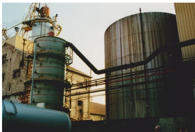
Le laveur à gaz et une cuve à fuel
